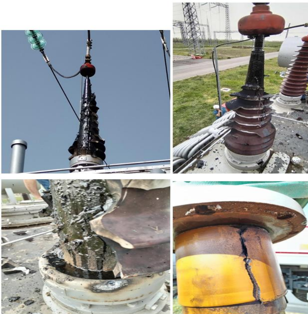
Slika 4: Havarisan provodni izolator
